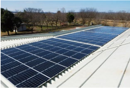
屋根上で稼働する太陽光発電設備
